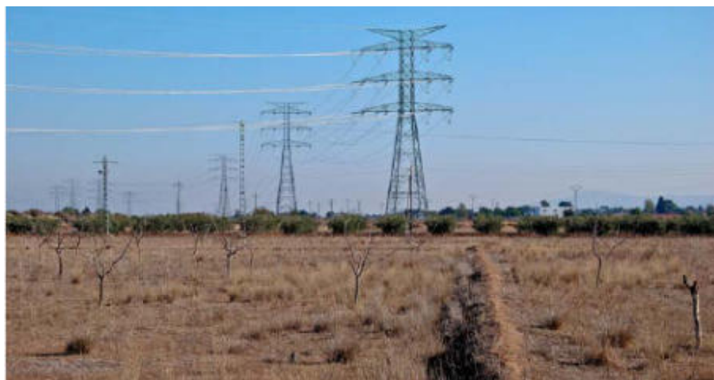
Imagen. Torre de Alta Tensión
