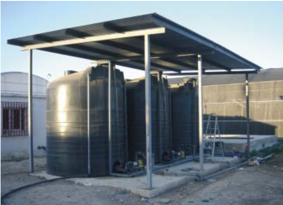
Foto 2 Detalle de los depósitos de PE de 10.000 litros de capacidad cada uno, con sus respectivos equipos de bombeo para el riego de las parcelas del ensayo.
