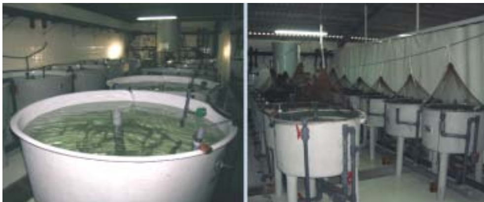
Figura 1 Circuitos en recirculación de agua marina para el mantenimiento de peces y moluscos cefalópodos en las instalaciones del IMIDA.
